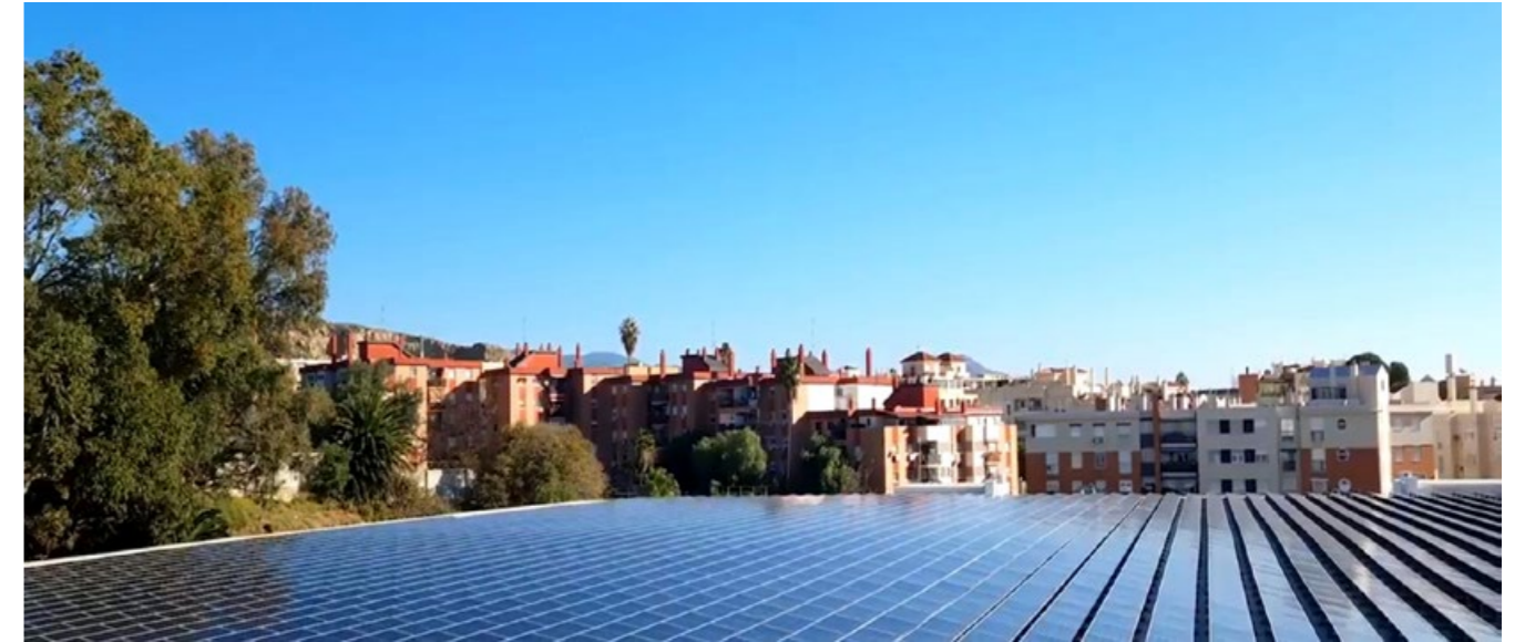
Planta solar municipal en la planta de desalación de El Atabal. Fuente: Ciudad de Málaga.
