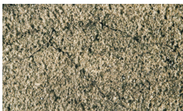
Revoco antiguo fisurado
