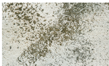
Pintura filmógena deteriorada
